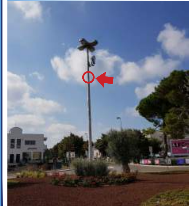
Foto sito di installazione telecamera
