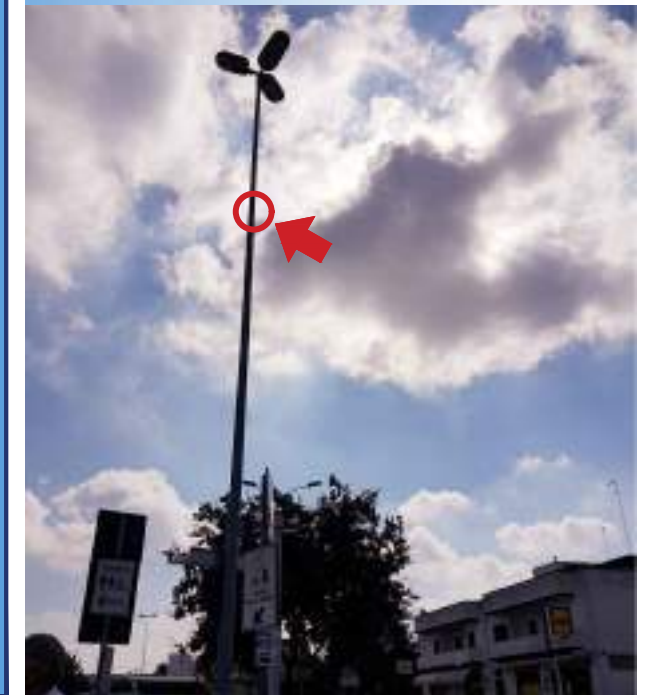
Foto sito di installazione telecamera
