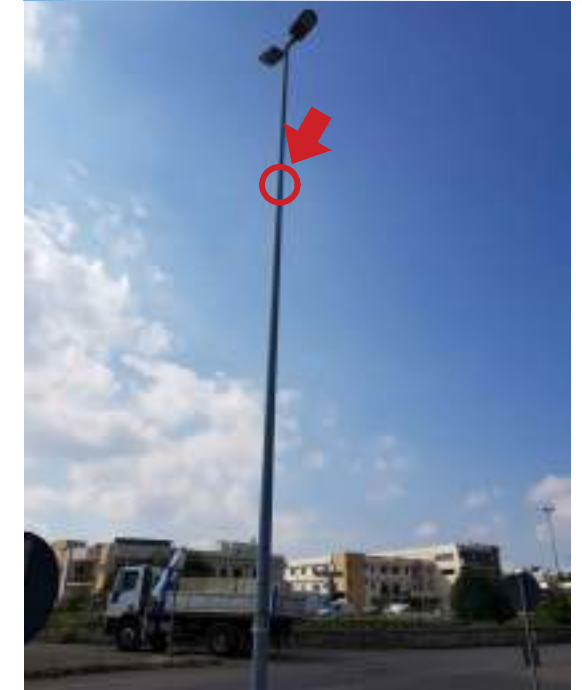
Foto sito di installazione telecamera
