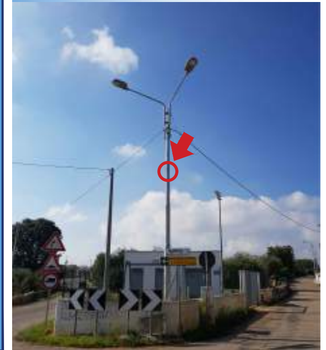
Foto sito di installazione telecamera
