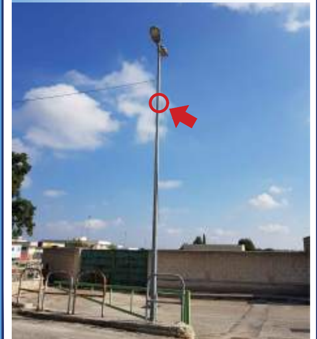
Foto sito di installazione telecamera
