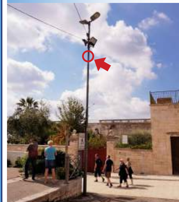
Foto sito di installazione telecamera
